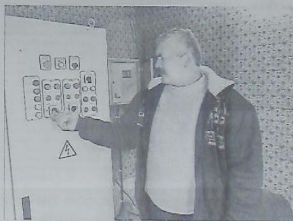
◆ Обходчик канализационных насосных станций Сергей ПУДОВКИН знакомит с работой автоматики.
